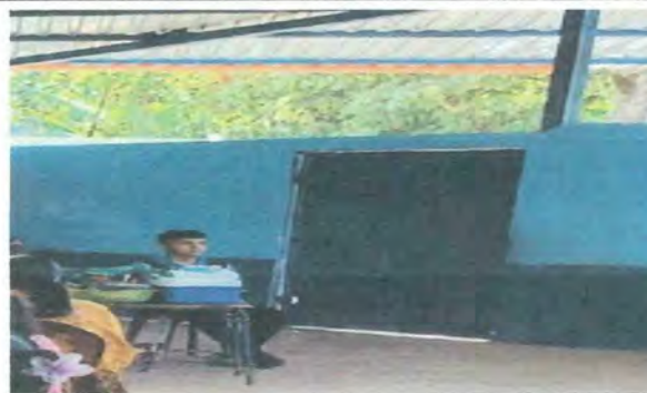
Foto 2: Sustitución del portón de entrada del centro educativo que amerita su intervención por encontrarse deteriorada.
